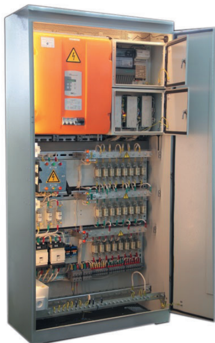
Рис. 15. Модернизированный автоматический пункт питания наружного освещения с регулятором напряжения АППНО-РМ
